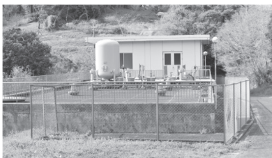
曾呂地区の水道施設
