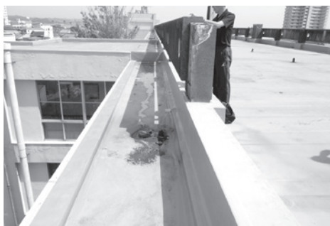
令和元年の台風15号により落下したコンクリートパネル(鴨川小学校)
