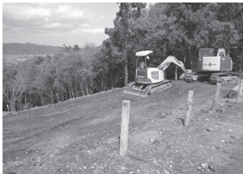
残土の大量持込がされた現場（嶺岡林道）
