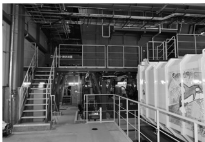
令和4年9月1日から稼働した「クリーンステーション鴨川」
