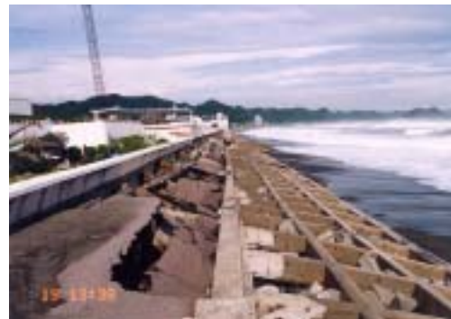
写真-2 護岸および管理用通路の被災状況(平成9年撮影)
