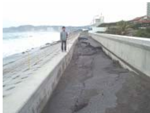
写真-3 管理用通路の陥没(平成14年撮影)
