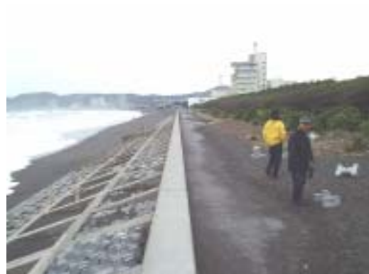
写真-4 護岸被覆ブロックの飛散状況(平成14年撮影)
