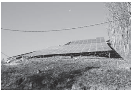
山の斜面に設置された太陽光パネルの一例
