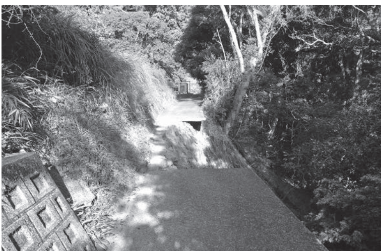
昨年の台風第13号により崩落した市道（打墨）
