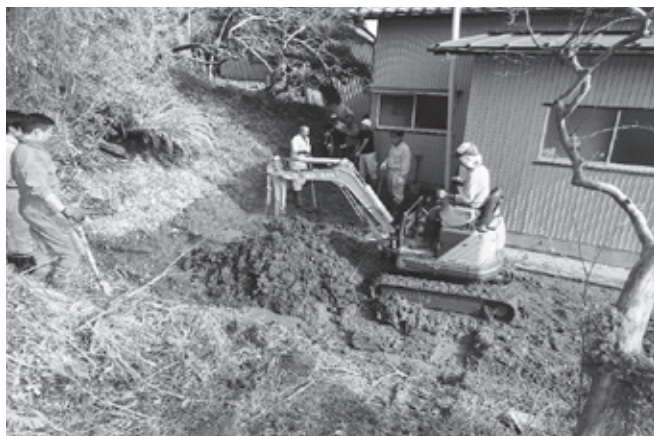
住宅に流入した土砂の撤去作業
