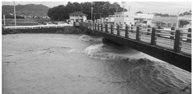
大雨で増水した貝渚橋付近
