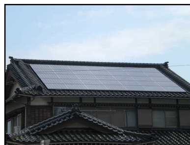
住宅用太陽光パネル
