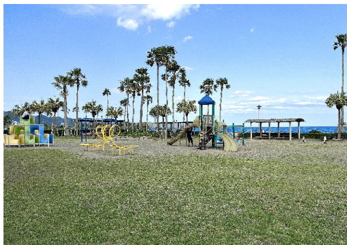
公園遊具が老朽化している
