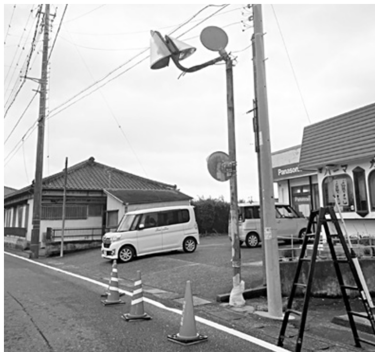
老朽化により撤去を進めている街路灯
