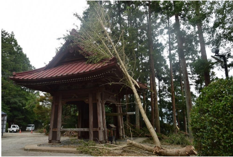
令和元年（2019）9月房総半島台風による被害（大山寺鐘楼（市指定文化財））
