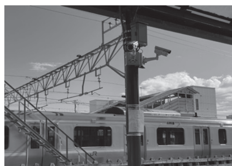
鴨川駅西口広場に設置された防犯カメラ
