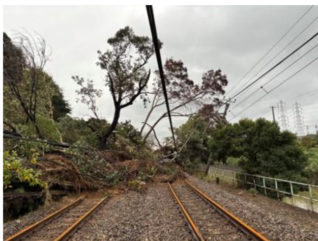
復旧工事着手前
