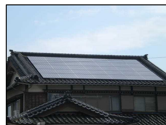
住宅用太陽光パネル
