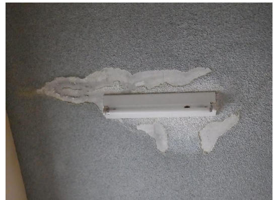
田原認定こども園 (保育園舎) (天井塗装剥れ)
