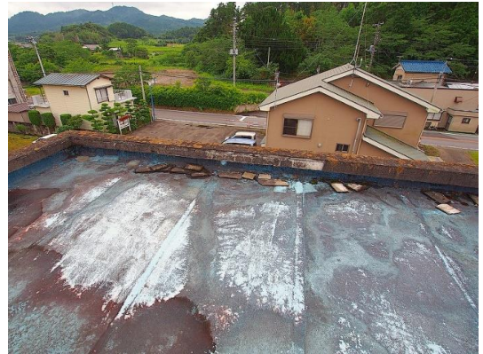
吉尾公民館 (シート防水・亀裂)
