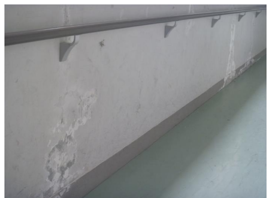
東条小学校 (廊下壁の漏水)
