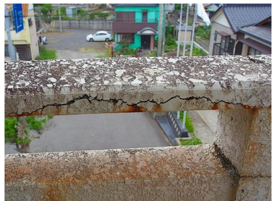
天津小湊支所 (手すりのひび割れ)
