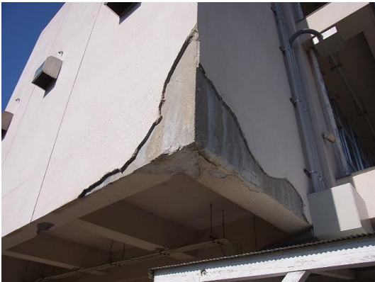
鴨川小学校 (モルタル剥落)
