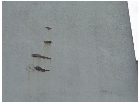
田原小学校 (鉄筋露出)
