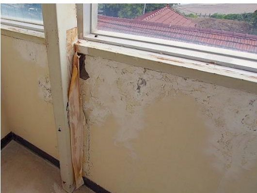
天津小湊公民館 (漏水、塗装剥離)
