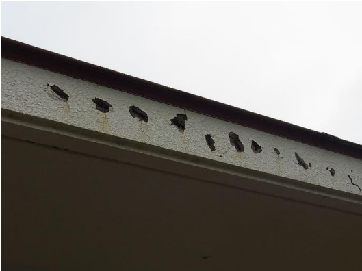
西条認定こども園 (保育園舎) (爆裂)
