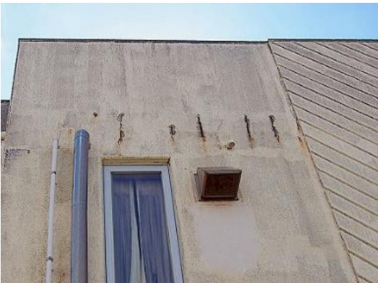
江見公民館 (亀裂、爆裂)
