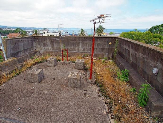
太海公民館 (保護防水・目地劣化)
