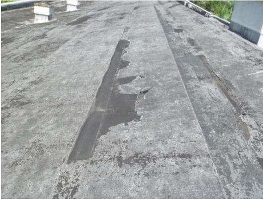
長狭認定こども園 (露出防水：表層剥がれ)
