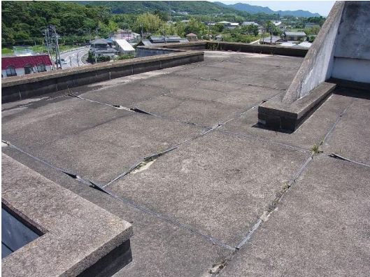
田原小学校 (保護防水：伸縮目地の劣化)
