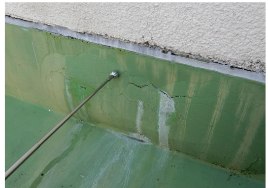
長狭中学校 (露出防水：防水亀裂)
