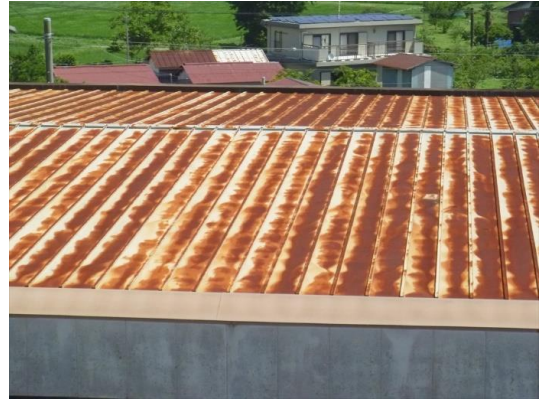
長狭認定こども園 (屋内運動場) (金属屋根：錆)
