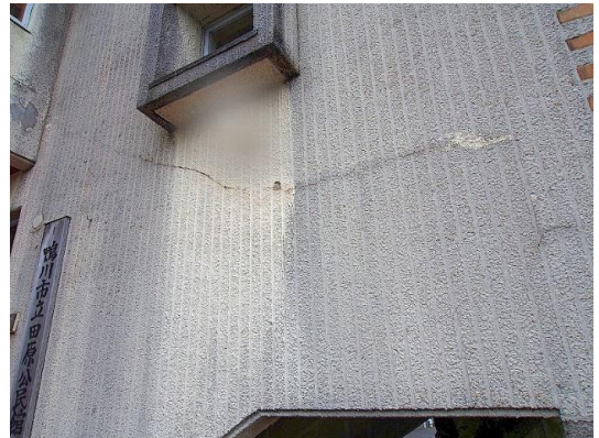
田原公民館 (亀裂)
