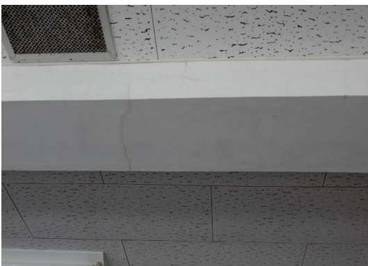
天津小湊小学校 (教室梁のモルタルひび割れ)
