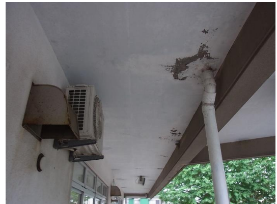
田原認定こども園 (保育園舎) (塗装剥離)
